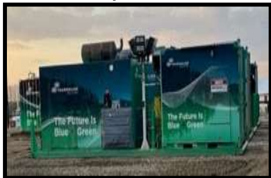
TOU NG Completion Generator
